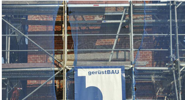
Bei der Renovierung in den 1950er-Jahren ging man beherrzt zur Sache: Störende Verzierungen wurden abgeschlagen, ein Spitzbogen wurde durch einen Betonsturz begradigt.
