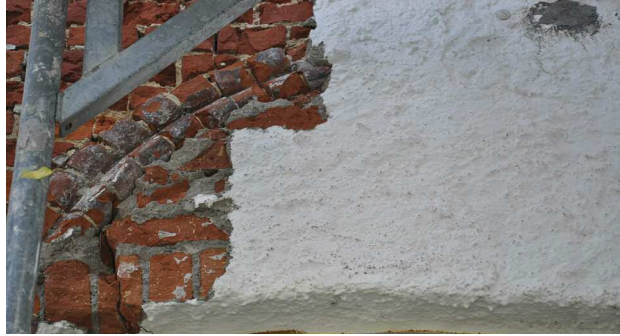
Unter dem Putz kam kunstvoll Gemauertes zutage, aber auch manch ein Schaden im Mauerwerk.
